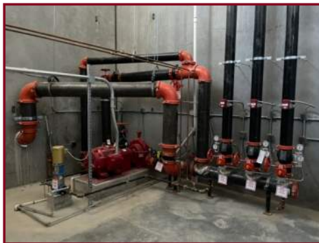
FIRE SPRINKLER RISER
