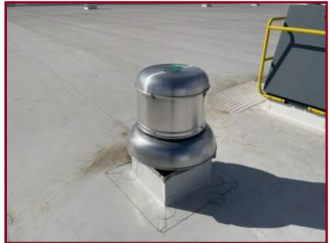
FIRE PUMP ROOM EXHAUST FAN
